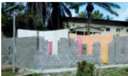
Das beim Sturm stark beschädigte, nach Professor Mai benannte Spitalgebäude. In Folge des Sturms mussten die Außenwände abgerissen und jetzt neu aufgemauert werden.
